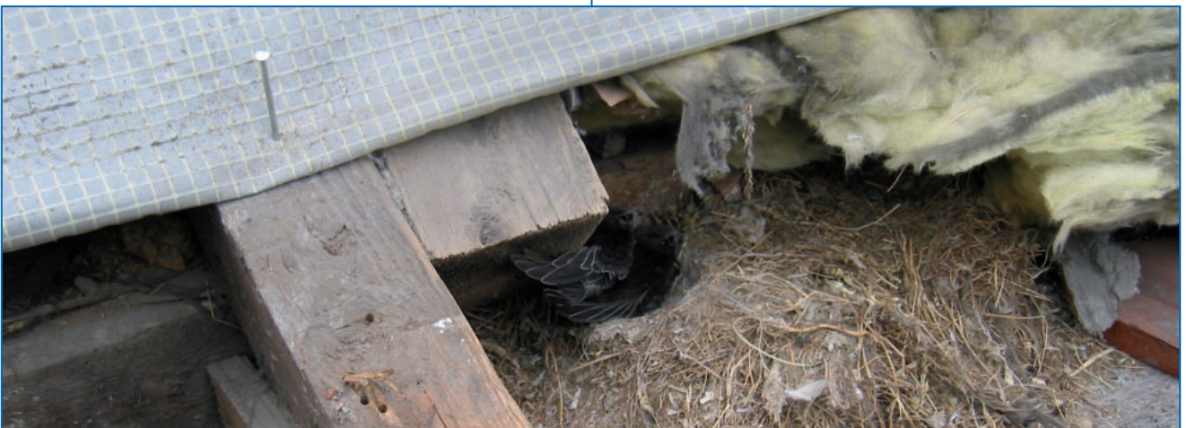
Abb. 4: bei einer Fassadensanierung freigelegtes Nest, Tüters Hof, 2.7.2003, Foto S. SALLERMANN
